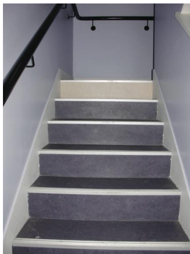
Sécuriser les escaliers
